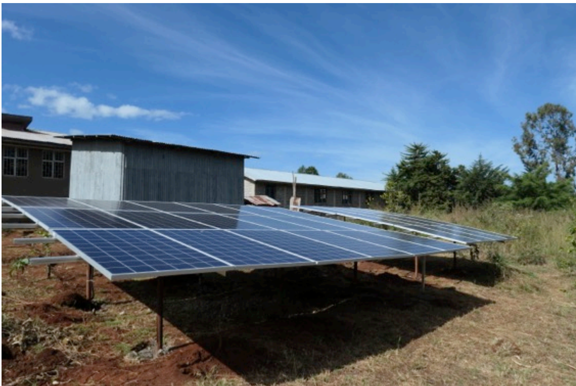
Die beiden Solarfelder in der Andnetschule mit 28.8 m 2 resp.19.2 m 2
